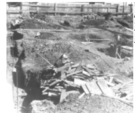
Fundação das obras do centro paroquial. Dificuldade pelo aparecimento do lençol freático
